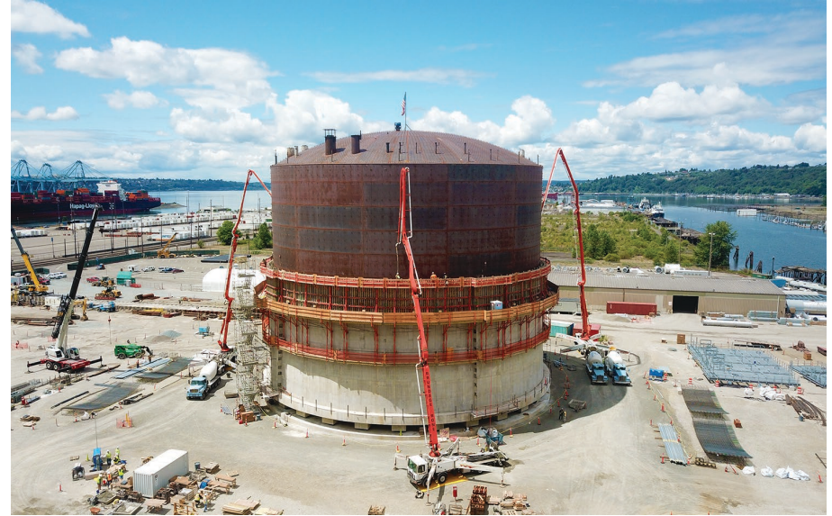
Tacoma LNG Tank Tacoma, WA
